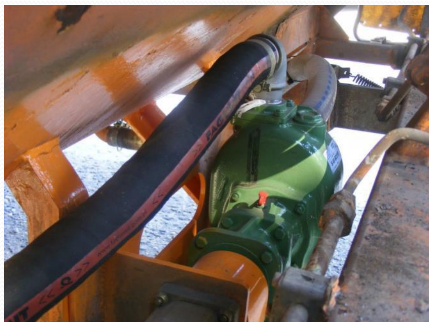
Pompa wody brudnej
